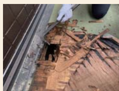
バルコニーの床をはがすとかなりの劣化
