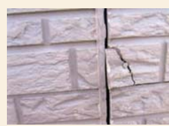
外壁に大きな亀裂
