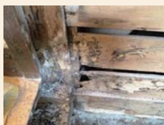
腐食やシロアリ被害も…
