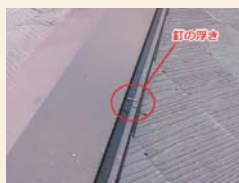
屋根の板金部の釘の浮き
